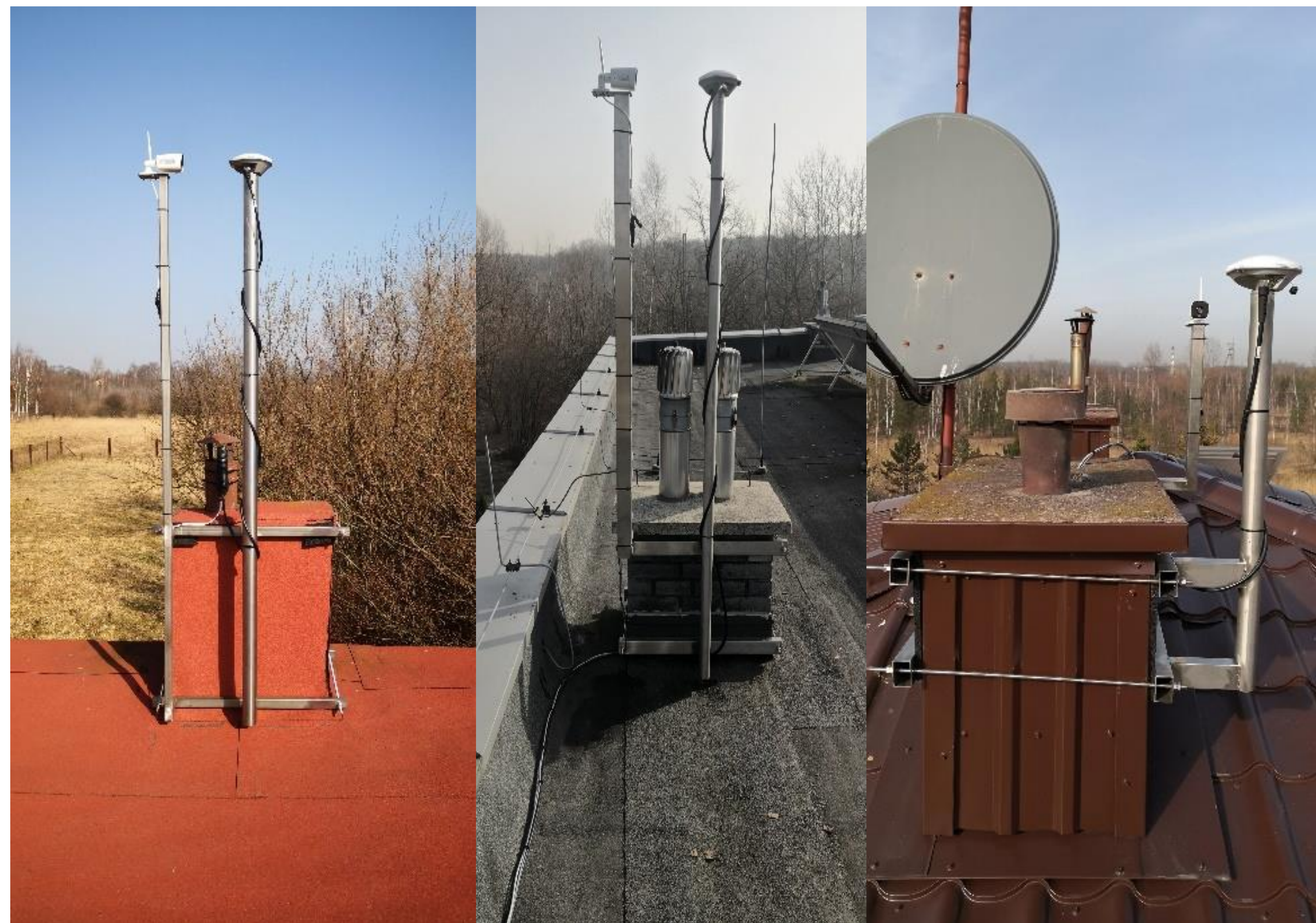
Anteny GNSS zainstalowane na stacjach monitorujących a) 8104, b) 8105, c) 8106
